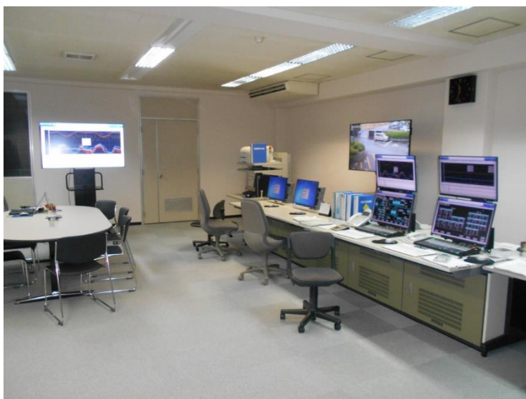
中央監視制御装置
